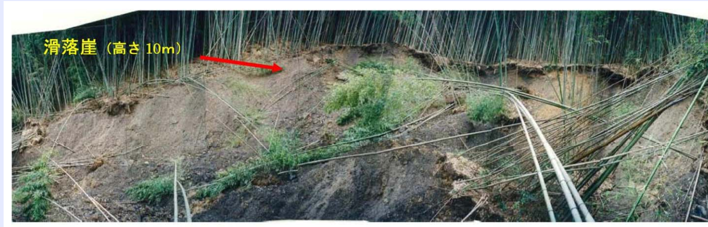
豪雨時に「ぼた山」で発生した地すべり性崩壊
